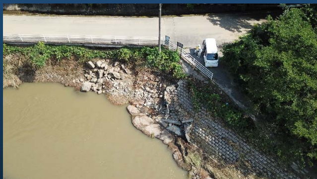
空撮による災害状況確認
